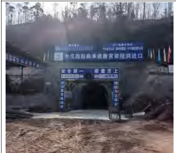
唐家梁隧洞入口截排水沟
