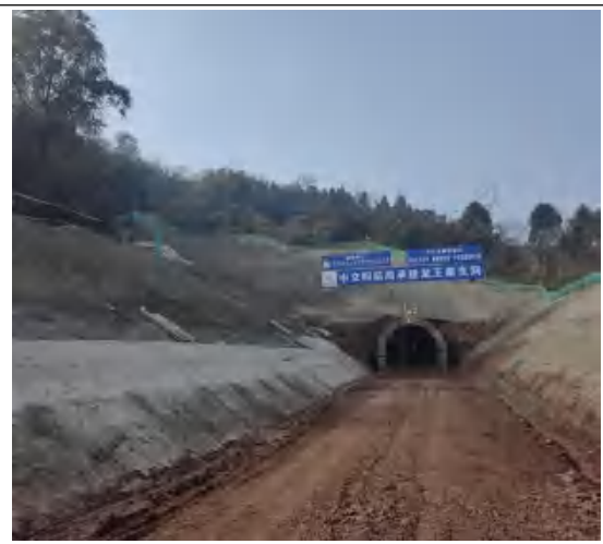
龙王寨支洞截排水沟、临时排水沟
